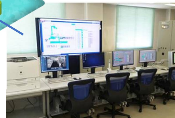
監視システム
